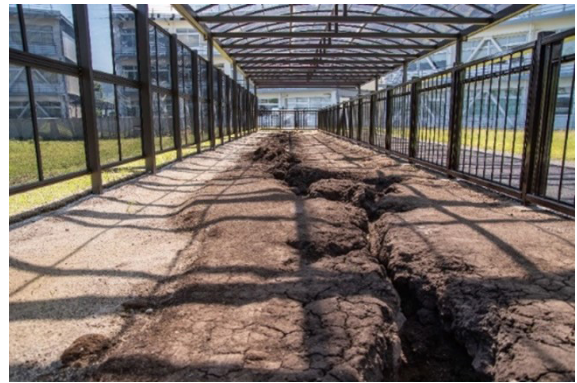
写真2 地表地震断層。
