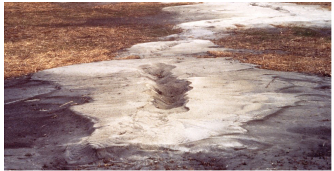
写真3 兵庫県南部地震で流れ出した噴砂(西宮市内で筆者撮影)
