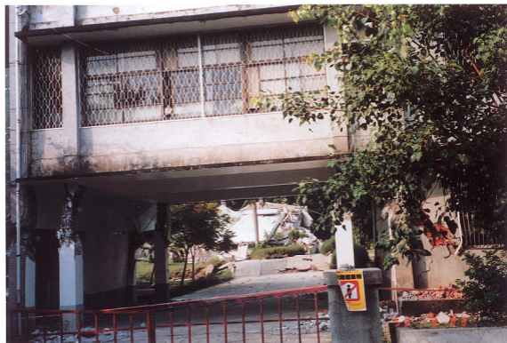
4. 光復中学校を横切る地震断層(太田撮影).
