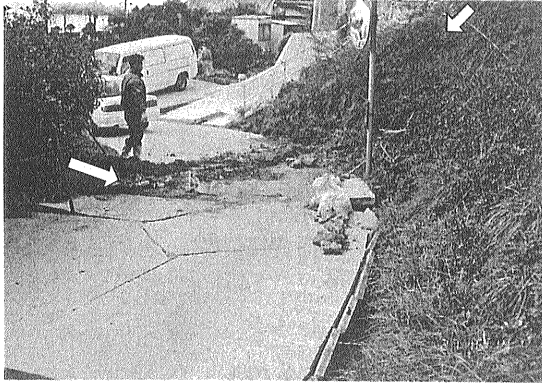
写真76-1 野島東地震断層上のコンクリート路面の破断と左横ずれ。中田 清一氏邸前の道路カーブ地点 [服部撮影 (1995.1.27)].
