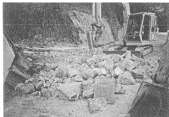
写真77-5 二つに破断した上部擁壁の内、北西側部分を除去した後の崖の状況。写真左上に花崗岩節理の目立った地肌が見える [上村建設(株)撮影(1995.7)].
