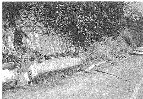
写真77-3 本震10日後の破断の進んだ状況 [服部撮影(1995.1.27)].
