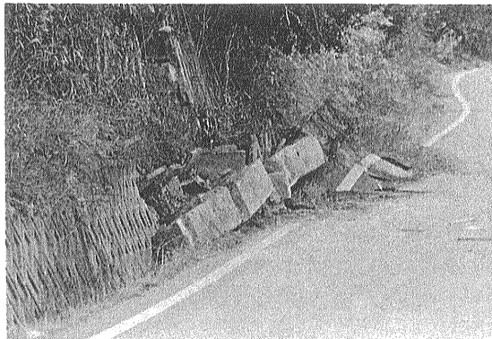
写真77-2 本震3日後の変状 [池上 龍雄氏撮影(1995.1.20, 2p.m.頃)].
