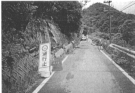
写真77-1 復旧工事直前の擁壁および路面の状況 [上村建設(株)撮影(1995.7)].
