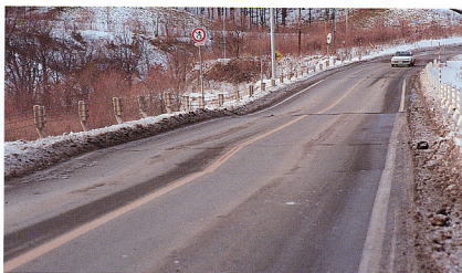
2. 標茶町茅沼の国道391号線白尾鳥橋前後にみられる道路被害の典型的な例。橋の前後にみられる路面を横断する割れ目を伴って盛土部分の路面が沈下している。手前の路面は沈下するとともに相対的に左に移動している。このような盛土の沈下・変形は程度の差こそあれ至る所で発生している。
