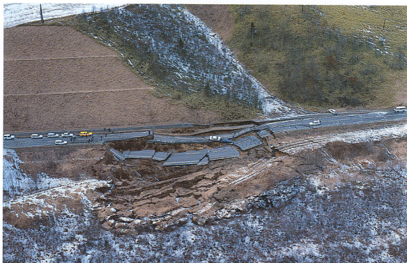
1. 厚岸町糸魚沢東方約3kmの国道44号線の路面陥没、湿原の上に築かれた旧道とその上の新道の盛土が地すべり状に崩壊している。(写真提供：株式会社シン技術コンサル)
