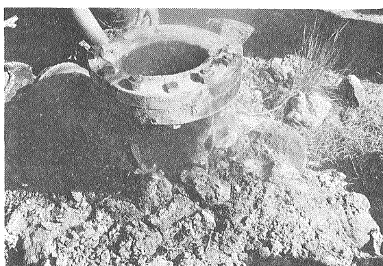
第14図 スチームボートで地熱開発用に掘られたボーリング。酸性が強いため栓をしたにもかかわらずパイプが腐食され 自然水銀が滴下している。(画面中央やや下のパイプの穴より)
