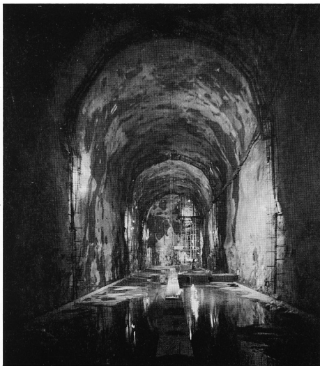
写真1 実証プラントの中心となる貯油槽(本文第4図①)の内部の完成後の写真。奥では石油受入用配管の工事が行われている。貯油槽の断面は幅15m 高さ20m 長さ112m。地質ニュース No.325 表紙の工事中の写真と比較して頂きたい。
