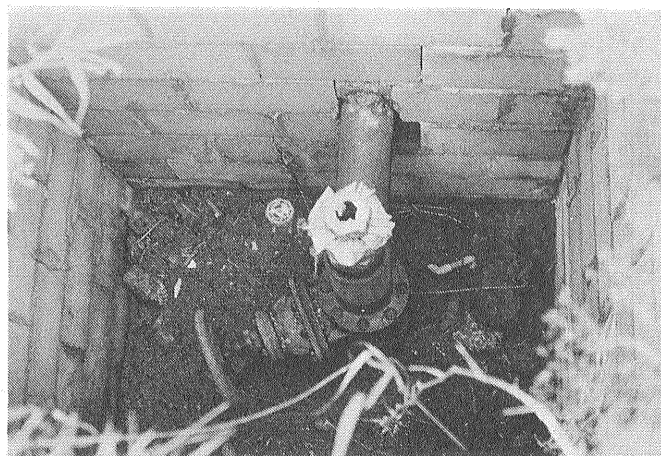
⑧ 沖縄県 1号試験井の坑口装置 435m の浅井戸であるが 得られた資料は大きい
