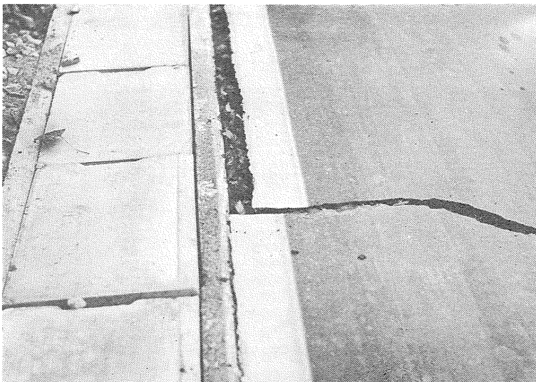
写真8：道路を横断する亀裂。この場合は片盛土の押し出しが原因（出戸湯川—中湯川間）。
