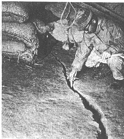
⑦ 昭和38年秋の亀裂 (近くの民家にて)
