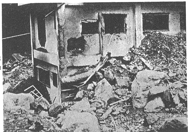
土石流におそわれた寿屋旅館 鉄筋コンクリート階建物の残骸 外壁は残ったが 2階の高さまで土石流の衝撃を受けた傷跡と土石の山はそのすさまじさを示す
