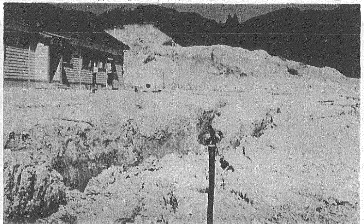
⑧ 胡桃小学校の破損と校庭の亀裂
