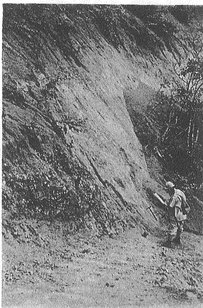
⑦ 胡桃小学校裏の滑落崖・すべり面および地層の風化状況
