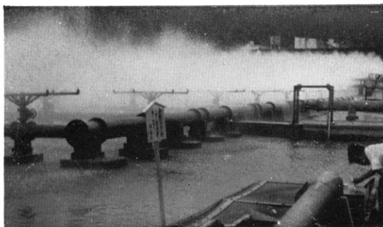
毎時 150 m 3 の地下水を毎時 6,000 m 3 の用水量にするため 一大噴霧冷却池をつくって循環使用している 伊吹山麓のセメント工場
