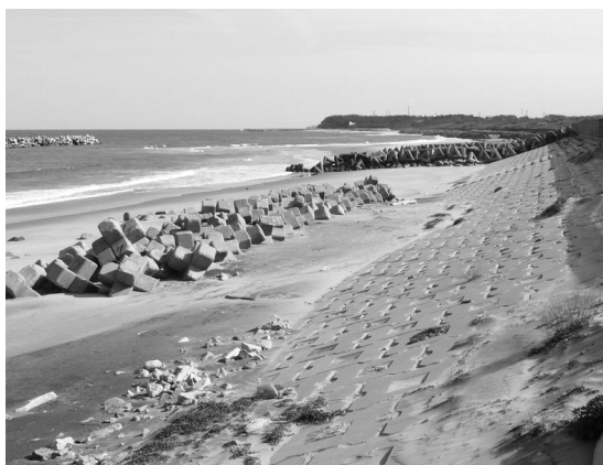
写真18 中浜海岸. 緩傾斜護岸の下に離岸堤が造られ, わずかに細かい砂の浜が残っています.
