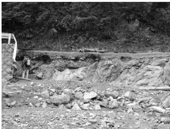
写真4 林道の崩壊状況.
