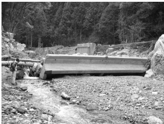
写真2 春日谷下流での橋の破壊状況.
