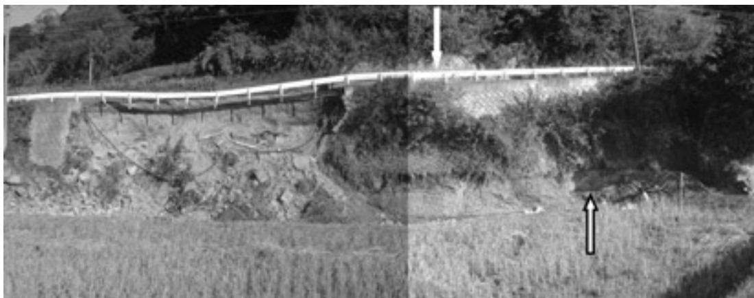
写真1 県道路面における地表地震断層(下向き矢印)と河床沿いの野島断層(上向き矢印)およびガードレールのめがんだ路肩と擁壁の崩壊地点(2004年11月22日撮影)。
