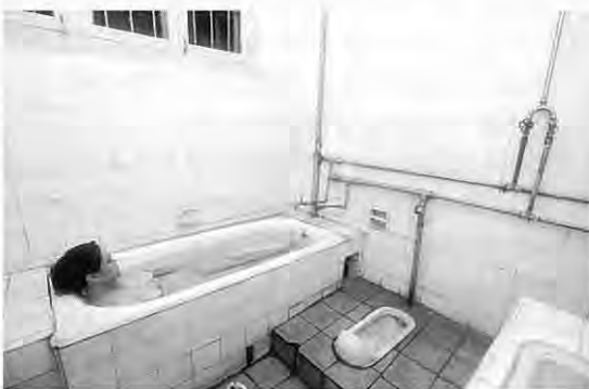
写真4 皮膚病療養棟として建てられた三号楼の部屋に付いている温泉浴サニタリー。写真では切れているが、上に温泉シャワー装置がある。
