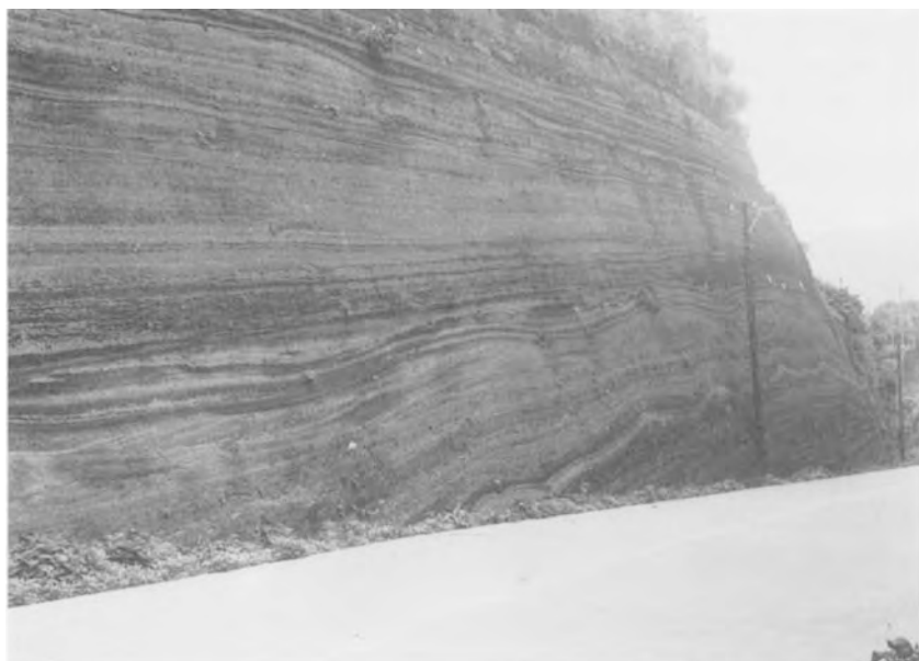
第25図 若郷火山火砕サージ堆積物。若郷集落南の切り通し
