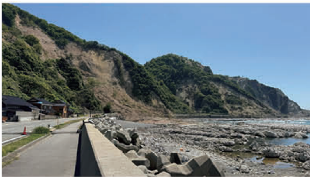
斜面崩壊の様子（珠洲市仁江町）。
