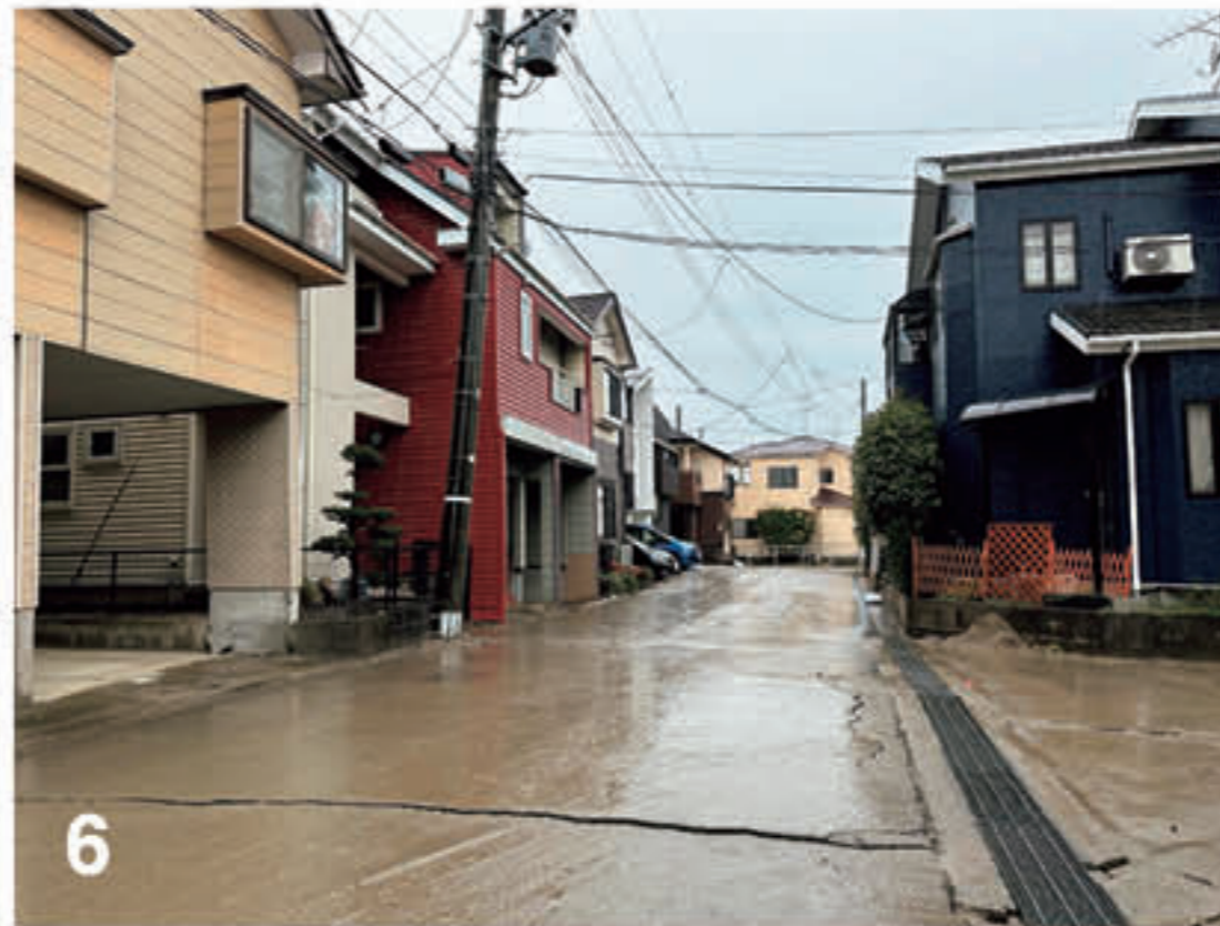
写真5, 6 砂丘内陸側の低平地盛土宅地における建物被害（新潟市西区寺尾）。 内陸側低平地では、層厚1-3 m程度、砂丘砂を用いて盛土造成されている。全体には内陸側にむかって緩く傾斜しており、建物が写真の左方向に水平移動している。建物の傾斜はごくわずかであるが、隣家の電気やガスのメーターが接触している。写真5の撮影：新潟大学災害・復興科学研究所。写真6の出典：ト部ほか（2024b）。
