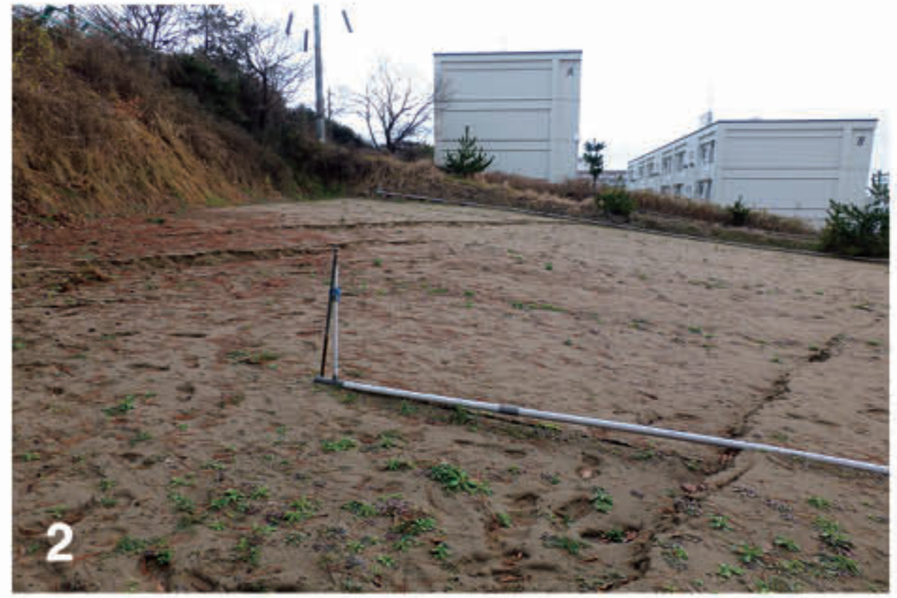
写真2 海岸砂丘の内陸側緩斜面（畑地）での引張亀裂（新潟市西区内野・大野）。 砂丘の内陸側斜面末端部は地下水位が非常に高く、液状化が発生したため、緩斜面の上部では地すべり性の移動が発生した。撮影：新潟大学災害・復興科学研究所。
