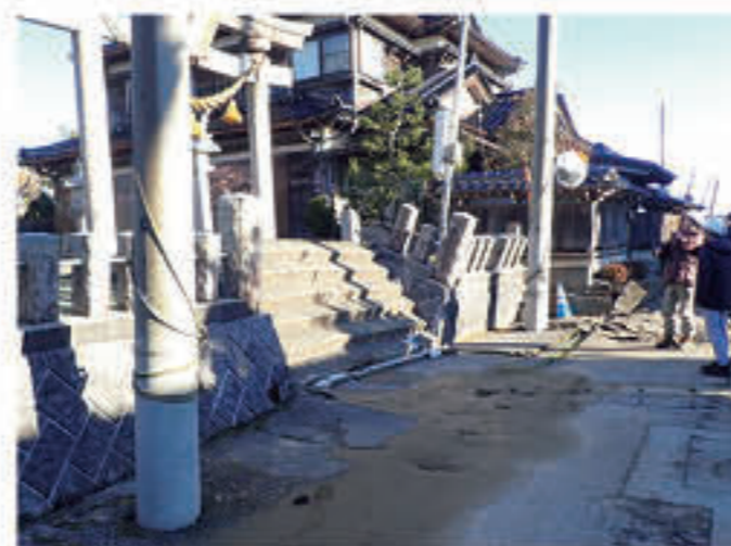
液状化・側方流動によって変形した神社の階段。
