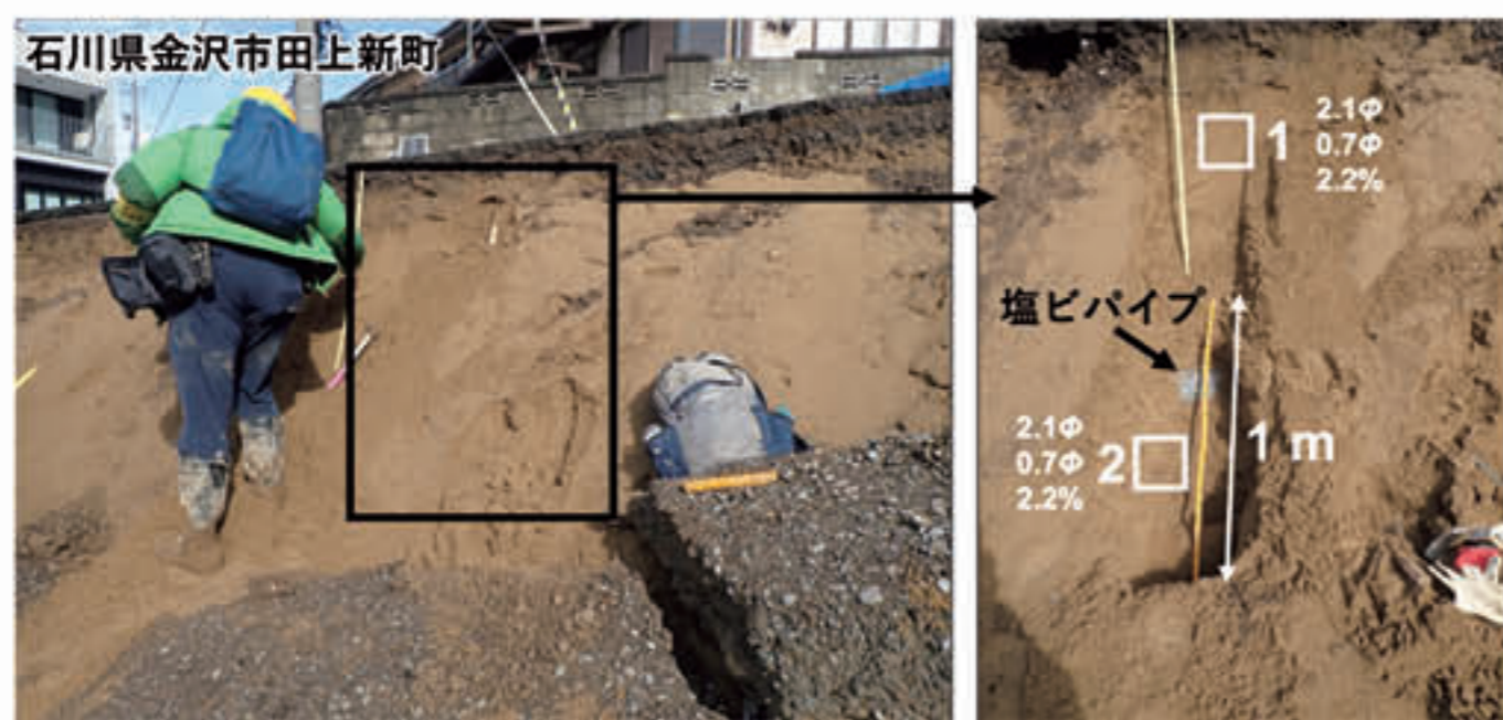
写真3 金沢市田上新町の崖地盛土の崩落崖に現れた盛土。 数値は上から平均粒径，標準偏差，含泥率。北村ほか（2024）
