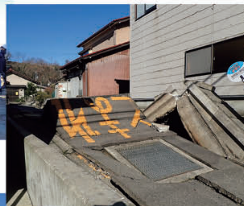
液状化・側方流動によって変形した道路。
