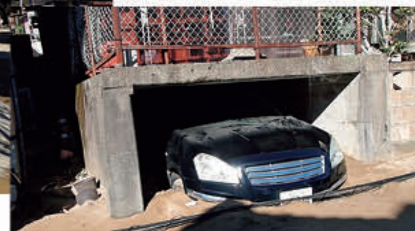
液状化・側方流動によって沈下した車庫。
