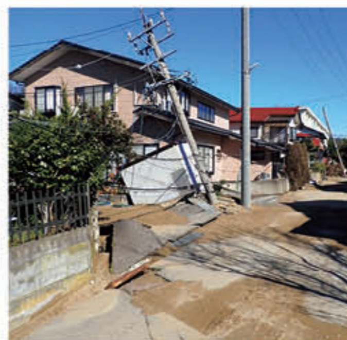
液状化・側方流動によって沈下・傾斜した電柱と変形した道路。
